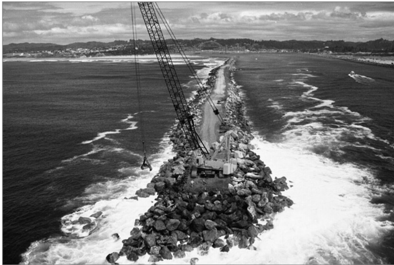
Figure 9.15 Grue sur chenilles travaillant sur la crête d'une digue (source : Brien Wegner, USACE)
