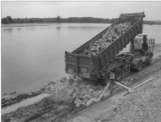
Figure 9.35 Exemple d'un camion de livraison qui déverse les enrochements directement en position sur le chantier (source : TPPL)
