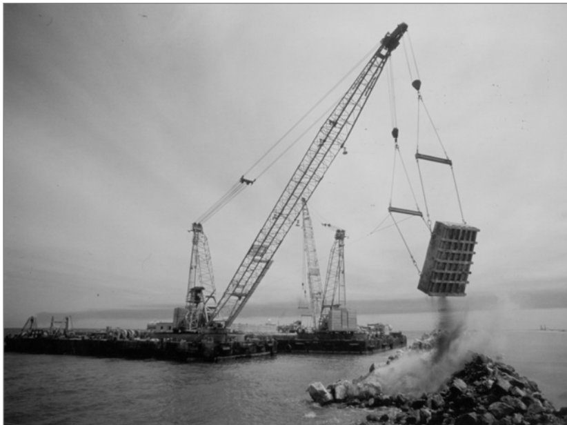
Figure 9.18 Mise en place d'enrochement à partir d'une grue flottante utilisant une benne ou un bac à enrochement (source : CUR)
