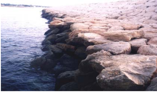
Fig 17: Longitudinal edge damage
